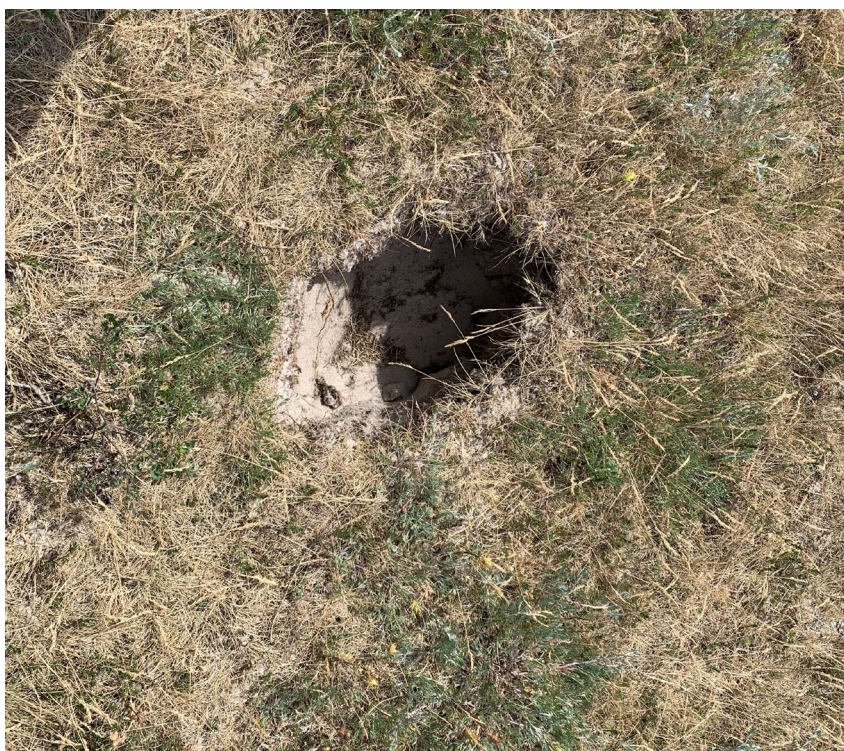
Figur 19 Gravet hul i diget ved st. 2130
