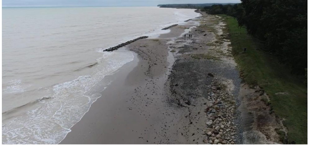
Figur 4-2 Relativt uberørt dige, beskyttet bag forstrand og bølgebrydere, i den østlige ende af digets strækning. Skaderne nederst på billedet er hvor strækningen uden bølgebrydere begynder. Foto fra Ulvshale-Fællesskov digelag efter stormen Babet.
