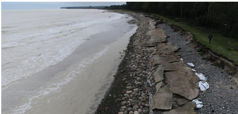
Figur 4-1 Skader på diget på strækning uden bølgebrydere. Foto fra Ulvshale-Fællesskov digelag efter stormen Babet.
