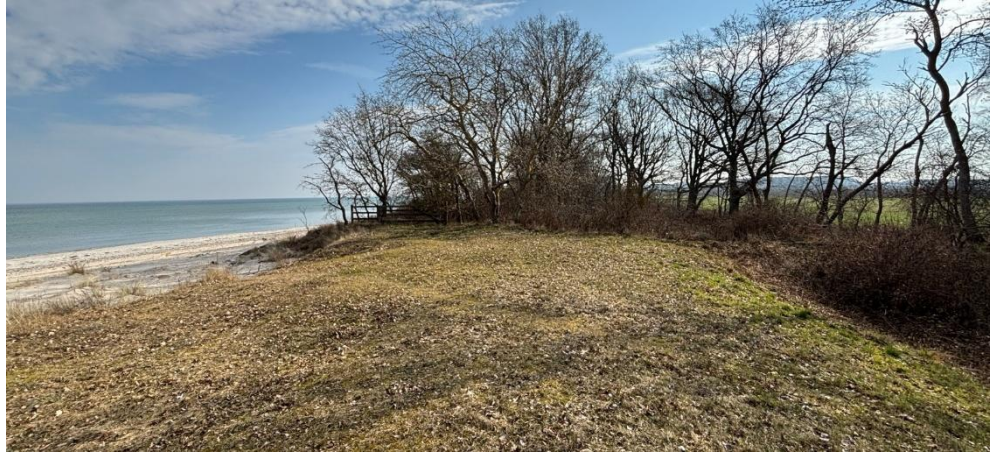
Figur 2-9 Østligste del af Nordre Dige Øst med sammenbygning med Østlige Dige. Der er læside-erosion efter afslutningen af erosionsbeskyttelsen havværts Østlige Dige.
