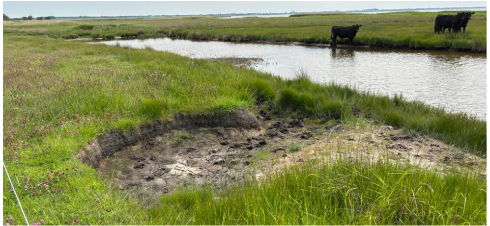
Figur 2-38 Lokale erosionsskår bør fyldes op, da de udgør svaghedszoner for diget
