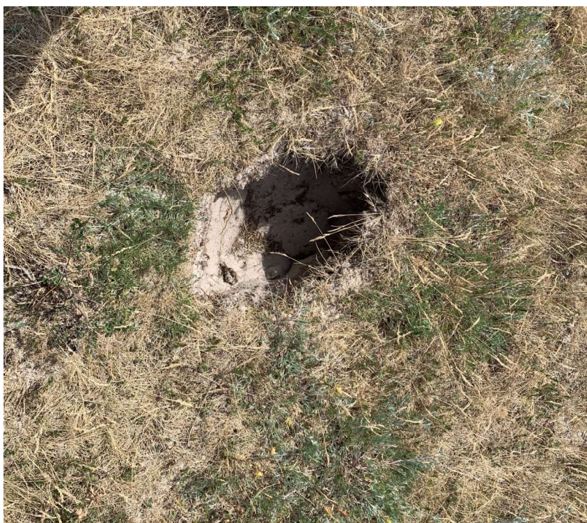
Figur 19 Gravet hul i diget ved st. 2130
